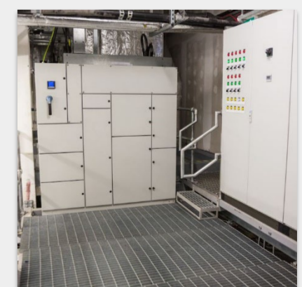
Überwachung von Heizung-Lüftung-Klimatechnik
