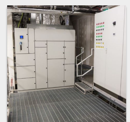
Überwachung von Heizung-Lüftung-Klimatechnik
