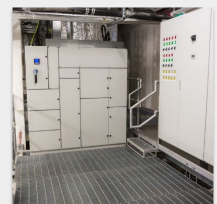
Überwachung von Heizung-Lüftung-Klimatechnik
