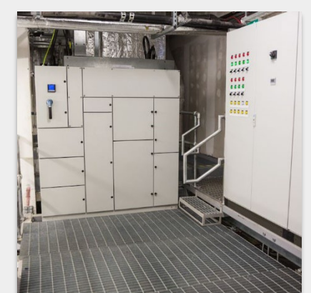
Überwachung von Heizung-Lüftung-Klimatechnik
